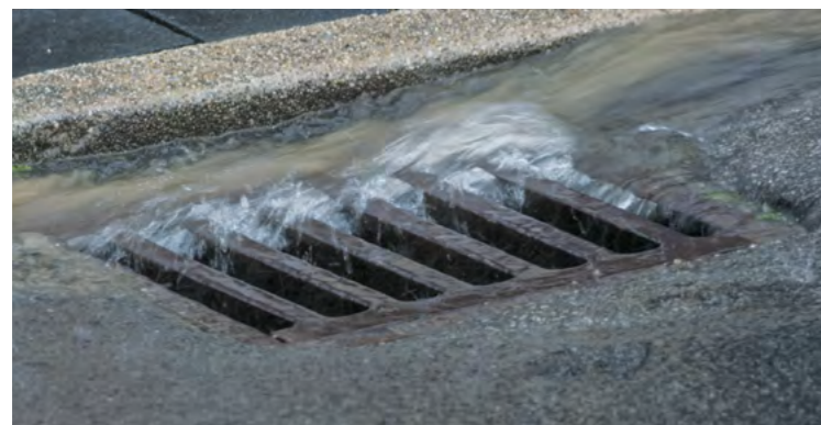
Rebosamiento de agua en sumidero de carretera durante una lluvia torrencial Água a transbordar do sumidouro durante chuvas intensas
