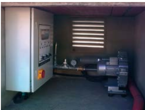
Cuadro eléctrico y compresor
