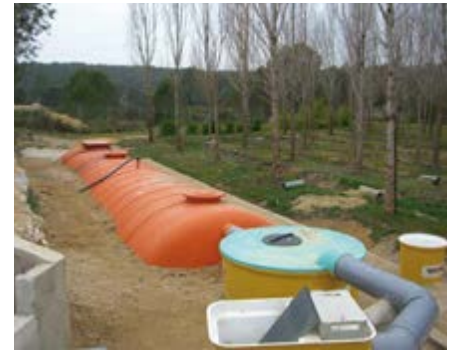
Instalação de depuradora de perfil hidráulico
