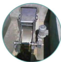
Grelha de gradagem automática
