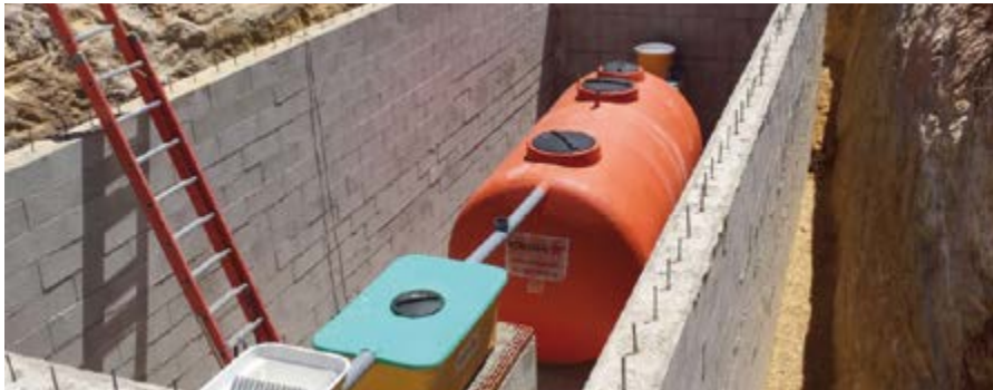
Instalação de depuradora de perfil hidráulico
