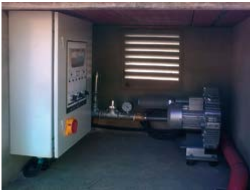
Quadro elétrico e compressor
