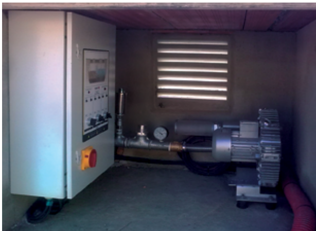
Cuadro eléctrico y compresor Quadro elétrico e compressor
