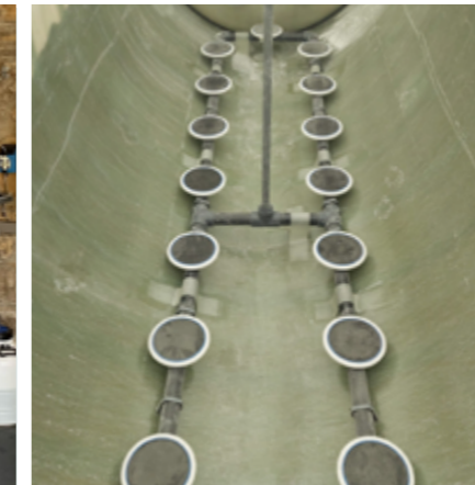
Estaciones de tratamiento Estações de tratamento
